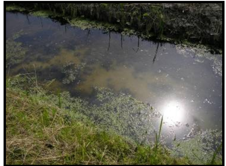
Zand-bentoniet op de bodem van de ringsloot: waarschijnlijk schade aan de afdichting door maaiwerk
