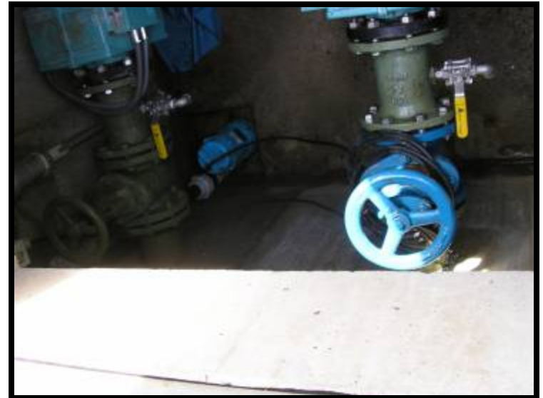
Centrale debietmeetpunt + telemetrie
