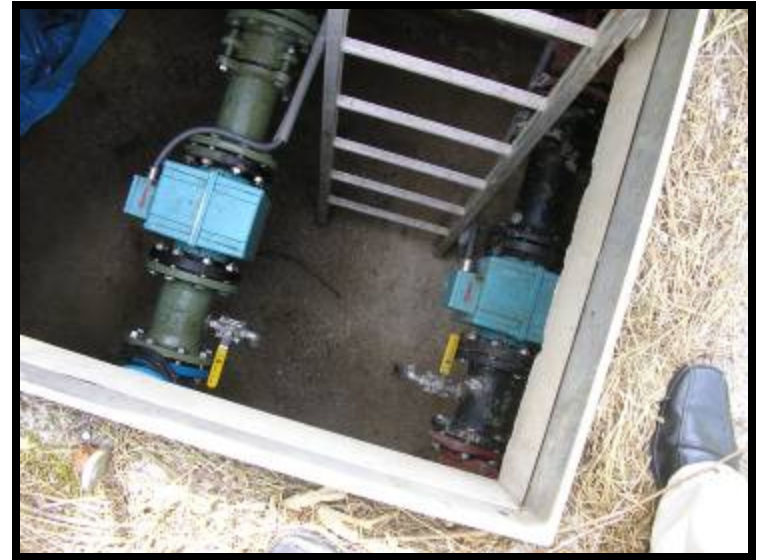
Centrale debietmeetpunt + telemetrie
