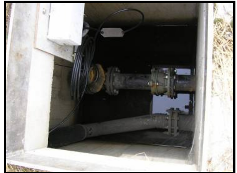
Inlaat ringsloot, met niveauregistratie
