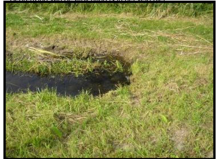
Inlaat Heemgebied, zijde sloot Heemgebied: gevoelig voor verstopping en beschadiging door maaimachines e.d.
