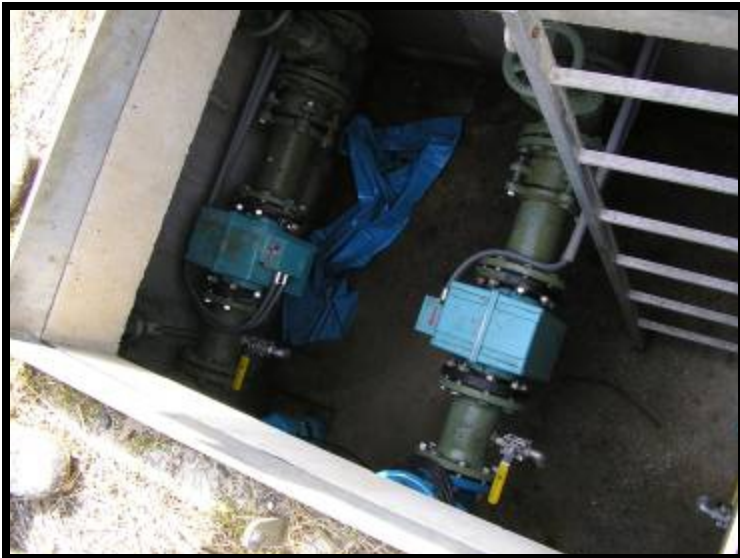
Centrale debietmeetpunt + telemetrie
