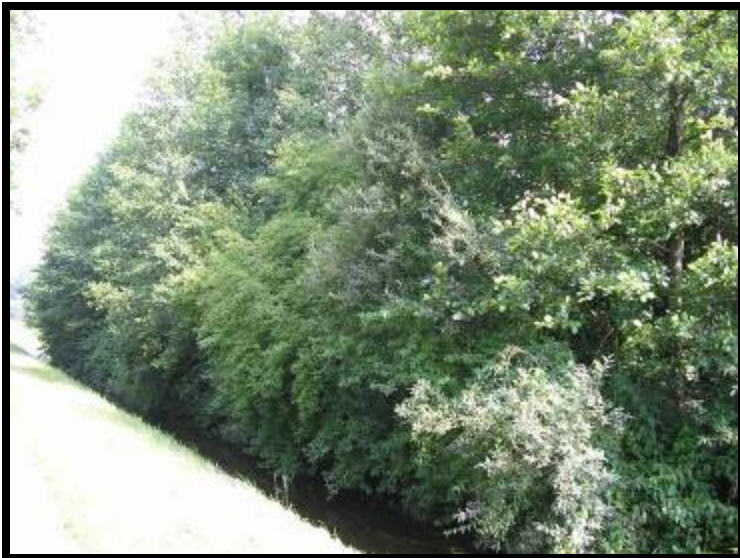
Begroeiing op de zij-afdichting aan de westzijde. Mogelijke wortelschade aan de afdichting.
