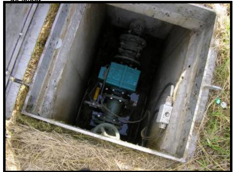
Debietmeter + telemetrie bij gemaal Heemgebied
