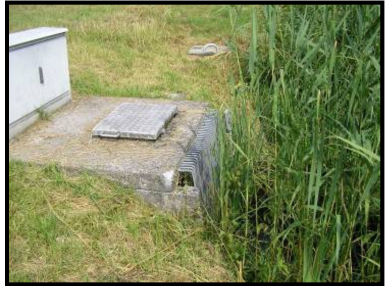
Gemaal Heemgebied: veel begroeiing in de watergang bij de inlaat
