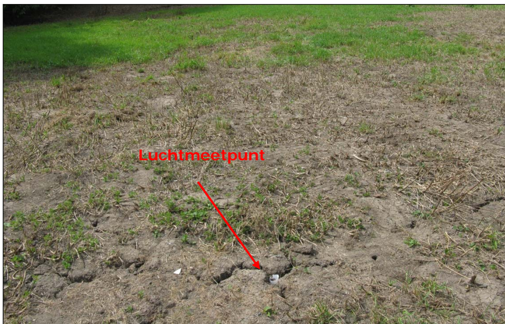
Figuur 13: Scheuren in maaiveld ter plaatse van hole 16, met luchtmeetpunt
